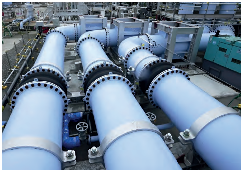
Рис. 17. Трубы для системы разбавления морской водой, идущие по площадке F-1
