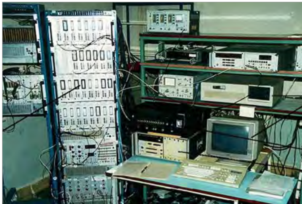
Рис. 28. Пульт управления системой «Финиш» на объекте «Укрытие»
